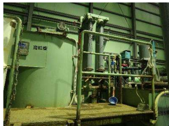
(b) 濁水処理設備
