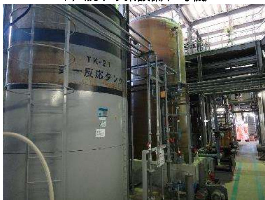
(e) 脱窒素設備
