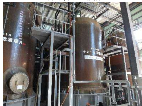
(d) 脱ホウ素設備(2号機)
