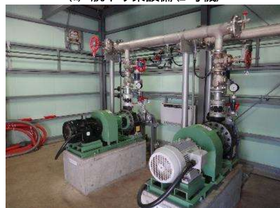
(f) 揚水設備
