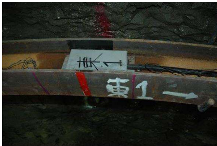
図 111 鋼製支保工応力計設置例
